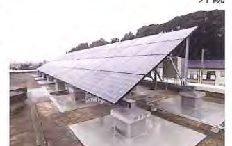
屋上に設置した太陽光パネル
